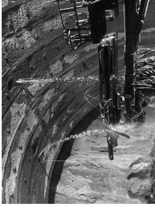
写真2 ロックボルト孔からの湧水状況
