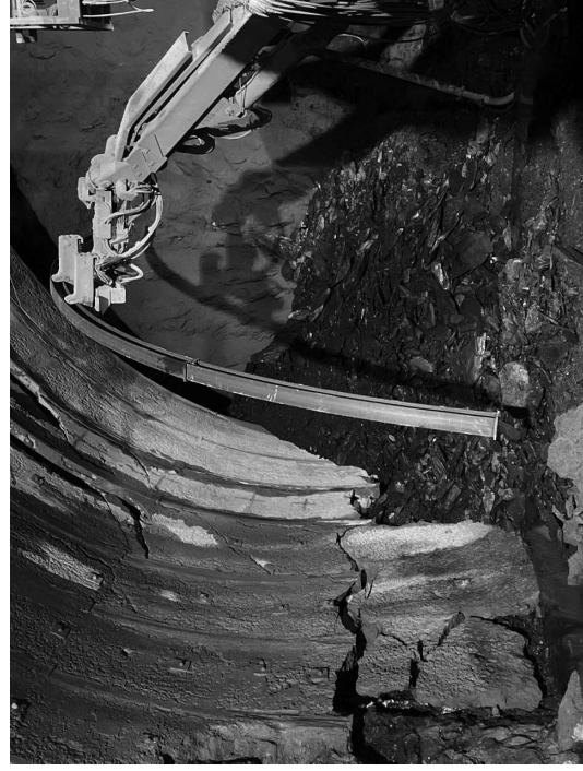
写真3 土砂流出の状況
