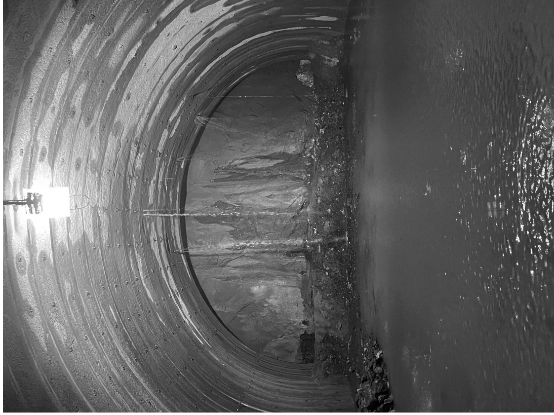
写真1 ロックボルト孔からの湧水と孔内の水没状況
